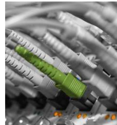
Оборудование для СКС
